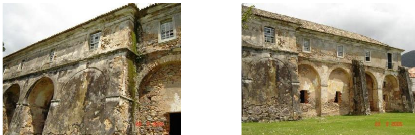
Figura 6: Fachada Nordeste atual, talude no corpo central avançado (esquerda) e contrafortes (direita) (10)
